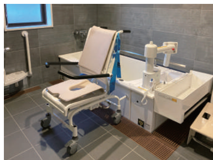
介護浴槽設備
